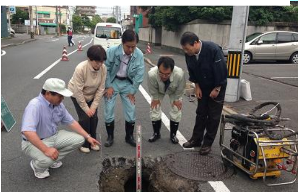
開削作業で空洞発見 (宇部市寿町)
