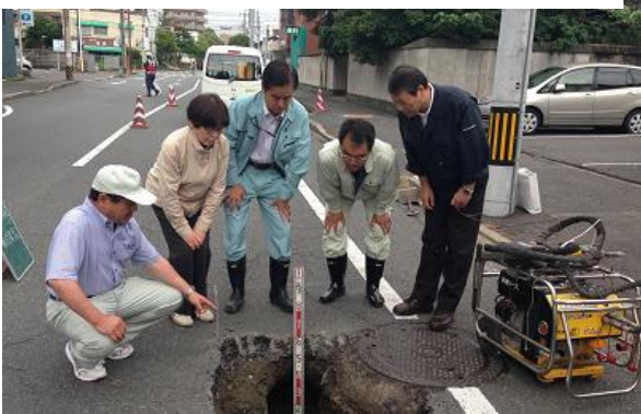
開削作業で空洞発見 (宇部市寿町)
